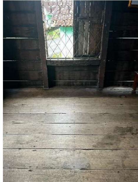
Kondisi Lantai Rumah penderita TB Paru
