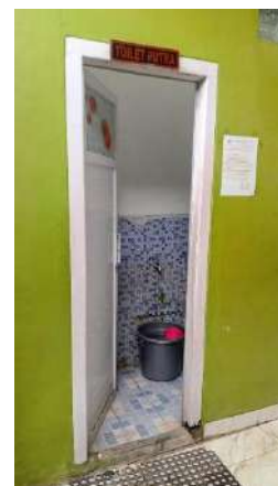
Toilet tanpa ventilasi
