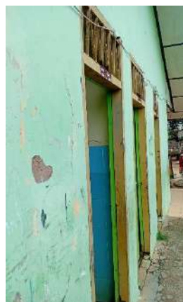
Toilet dengan ventilasi
