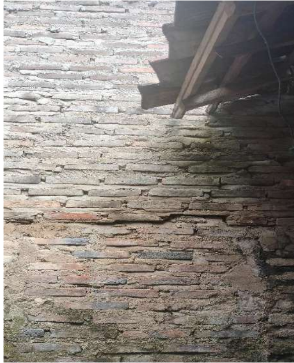
Dinding rumah yang tidak memenuhi syarat
