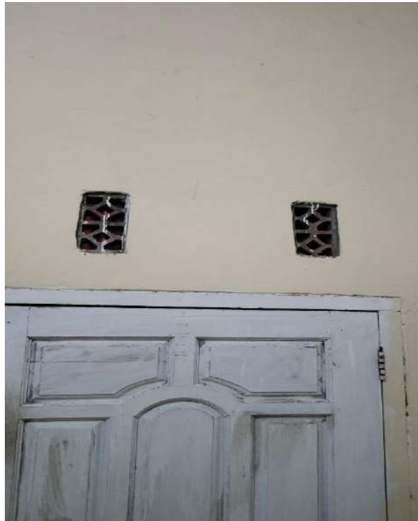
Luas ventilasi yang tidak memenuhi syarat
