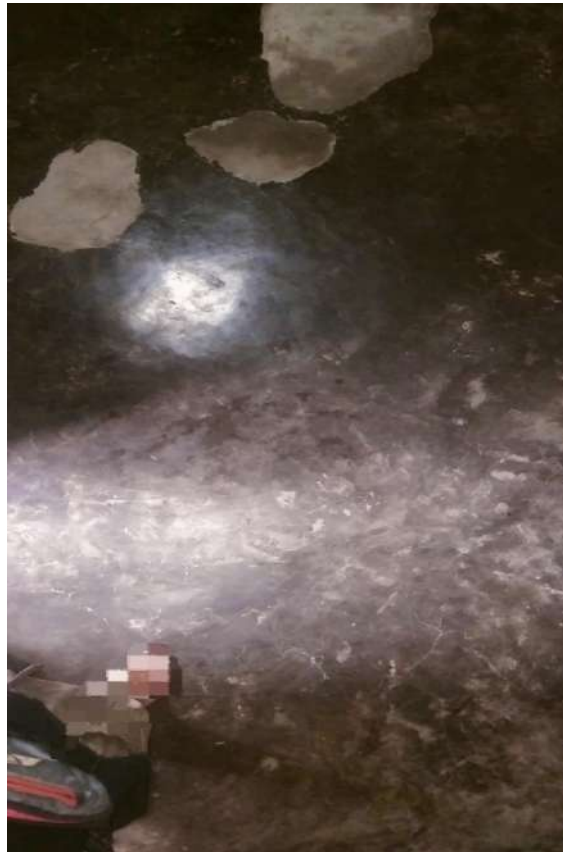
Lantai rumah yang tidak memenuhi syarat
