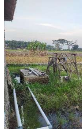
Kondisi Sarana SPAL
