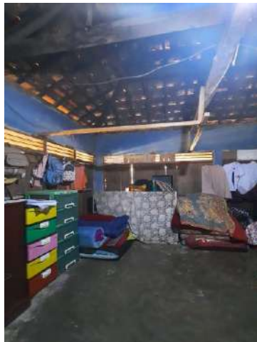
Kamar santriwati yang ventilasi nya ditutup kardus
