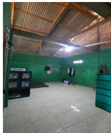
Kamar Santriwan yang tidak memiliki ventilasi
