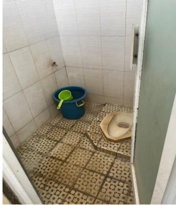
Kondisi jamban Masjid Mardhotillah
