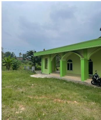
Kondisi Bangunan luar Masjid Al - Muttaqin
