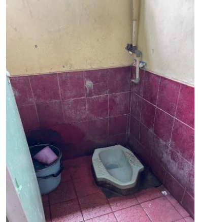
Kondisi jamban Masjid Nurul Hidayah
