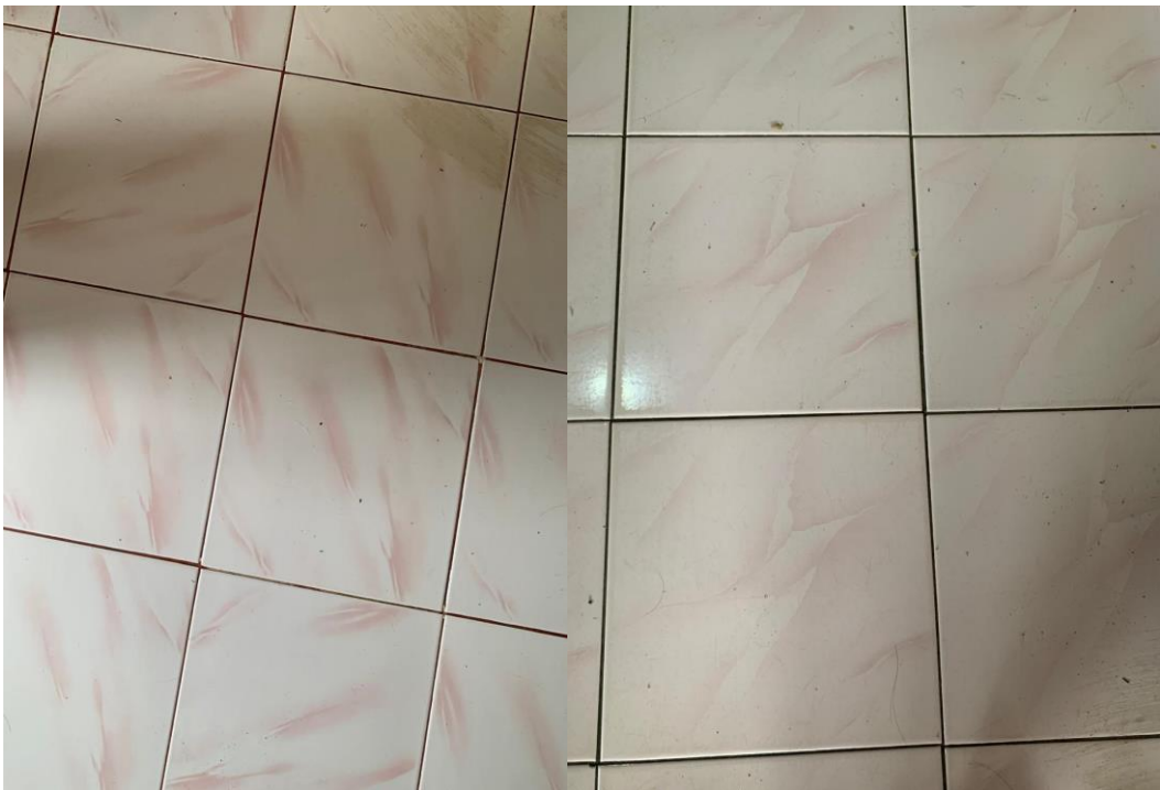
Kondisi Lantai Rumah Penderita TB Paru di Wilayah Kerja Puskesmas Natar Kabupaten Lampung Selatan
