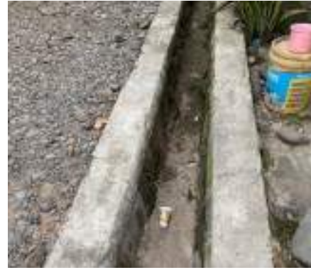
Gambar 14. Selokan tidak mengalir pada rumah (Responden FL)
