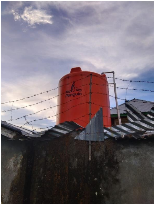
Sarana penampungan air bersih
