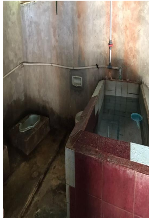
Sarana Penampungan Air Bersih
