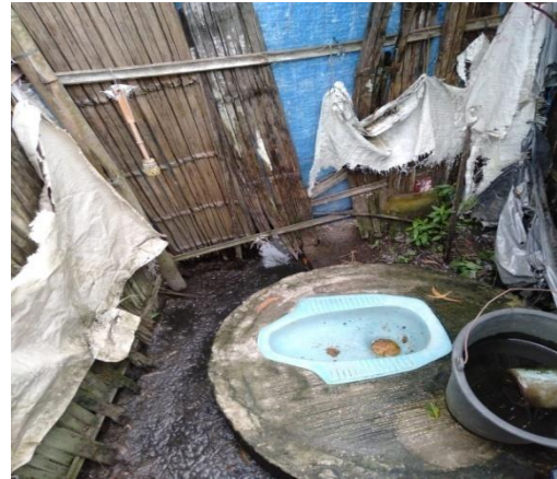
WC Tidak Memiliki Dinding
