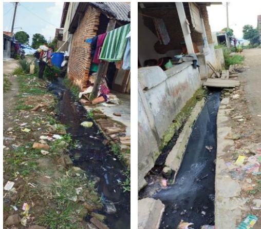
Gambar 5. Selokan air rumah warga yang tersumbat dan tergenang air
