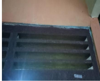
Ventilasi yang tidak dipasang kawat kasa
