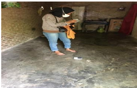
Kondisi lantai rumah penderita TB Paru Paru
