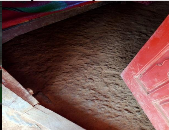
Kondisi Lantai Desa Sumber Alam
