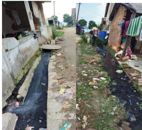
Gambar 6. Selokan air rumah warga yang tersumbat dan tergenang air didesa gebang
