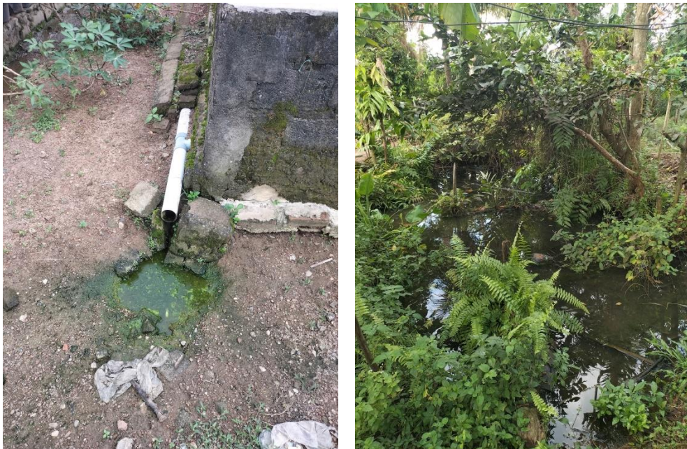
Gambar 4 Kondisi Sarana Pembuangan Air Limbah
