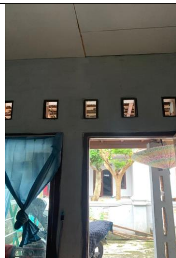
Ventilasi rumah yang tidak terdapat kawat kasa
