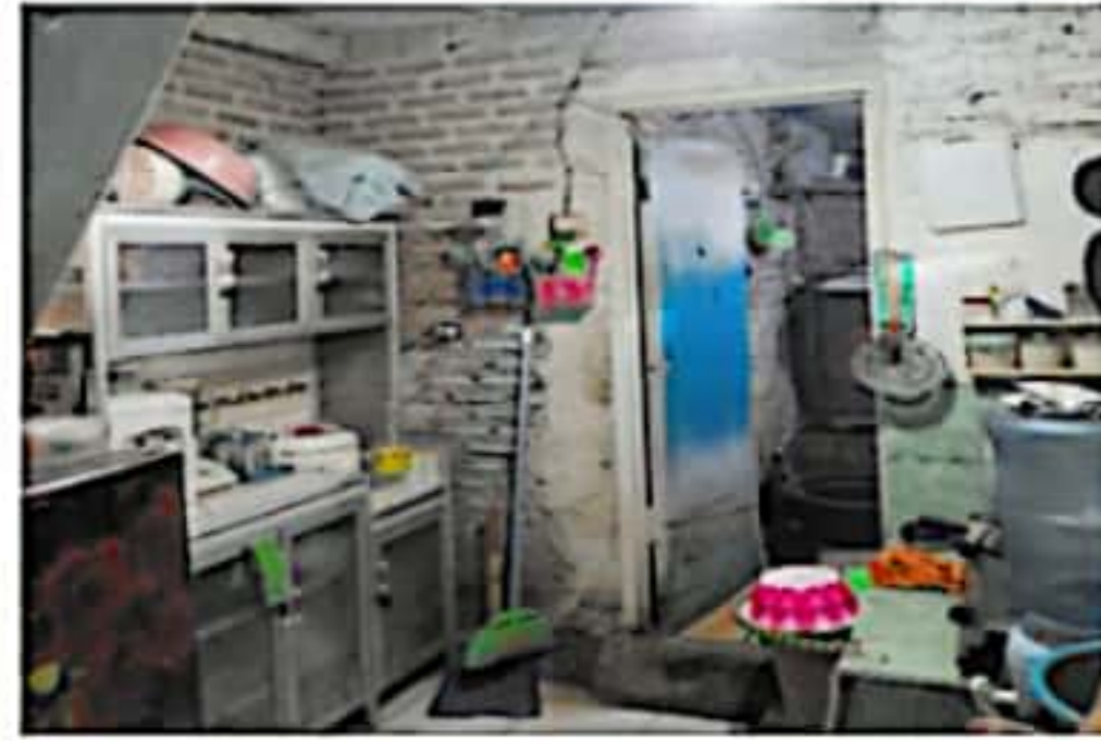
Kondisi Dinding Rumah Responden
