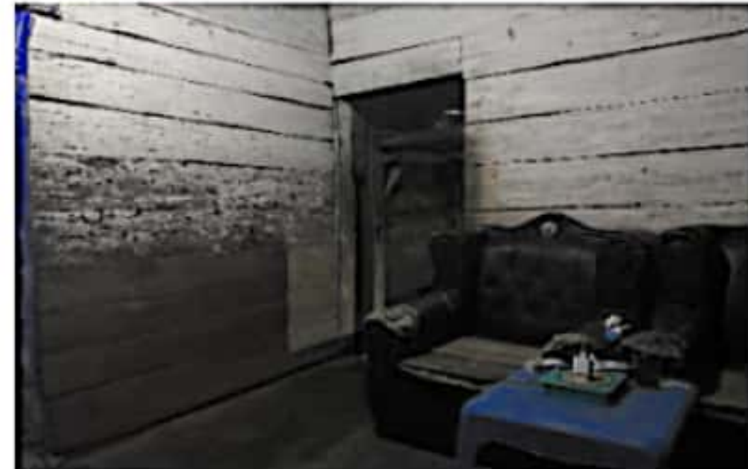
Kondisi Dinding Rumah Responden
