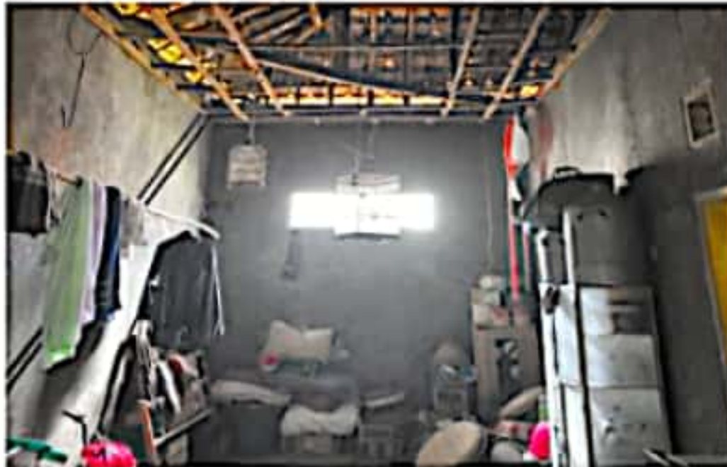
Kondisi Dinding Rumah Responden
