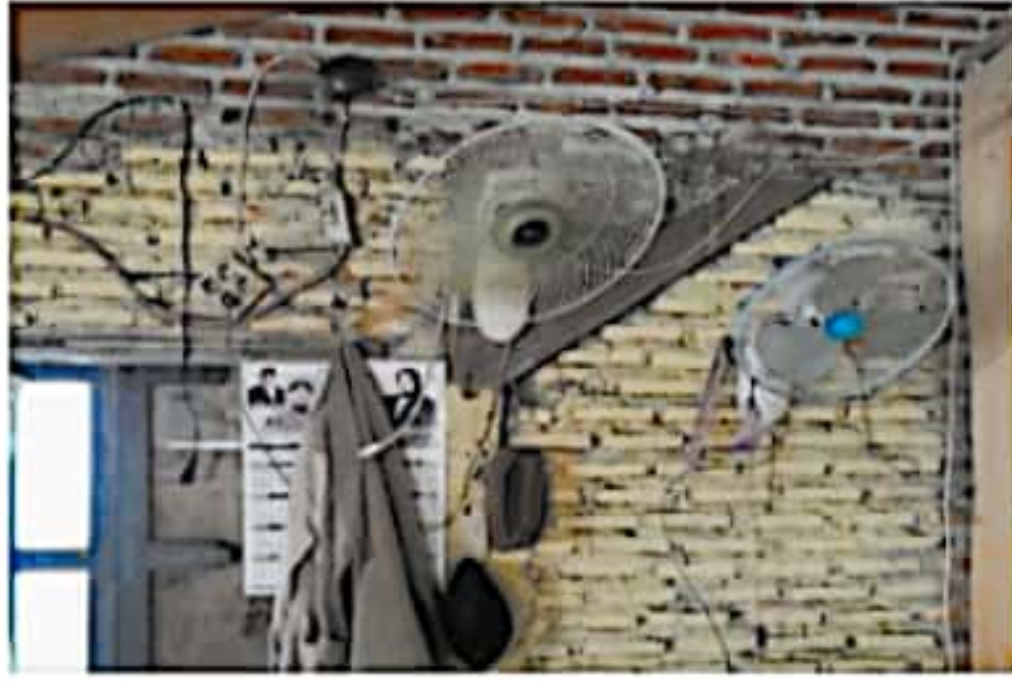
Kondisi Dinding Rumah Responden
