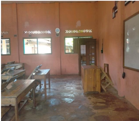
Kondisi lantai yang tidak memenuhi syarat di Sekolah Dasar
