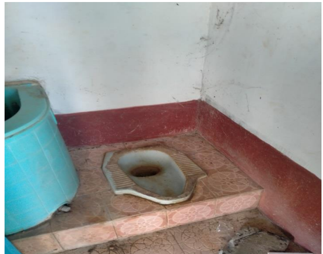
Kondisi jamban yang tidak memenuhi syarat di Sekolah Dasar
