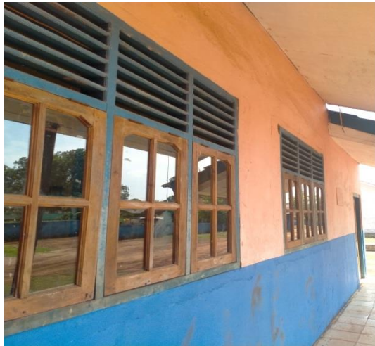
Kondisi dinding, ventilasi dan jendela di Sekolah Dasar yang tidak memenuhi syarat
