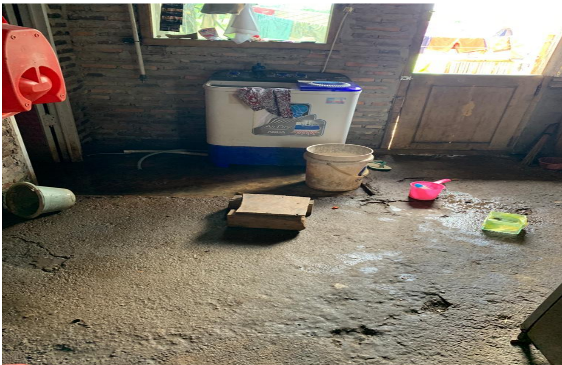
Kondisi Lantai yang tidak memenuhi syarat dirumah balita
