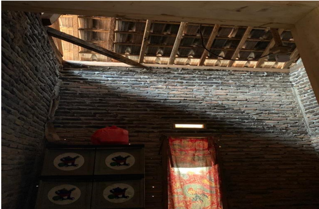
Kondisi dinding rumah balita penderita pneumonia
