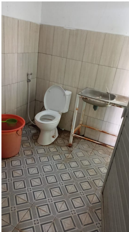
Kondisi toilet pengunjung/pasien laboratorium patologi klinik
