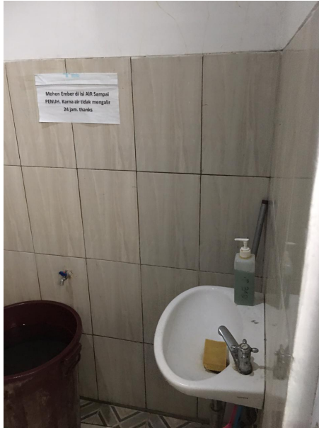
Kondisi toilet pengunjung/pasien laboratorium patologi klinik
