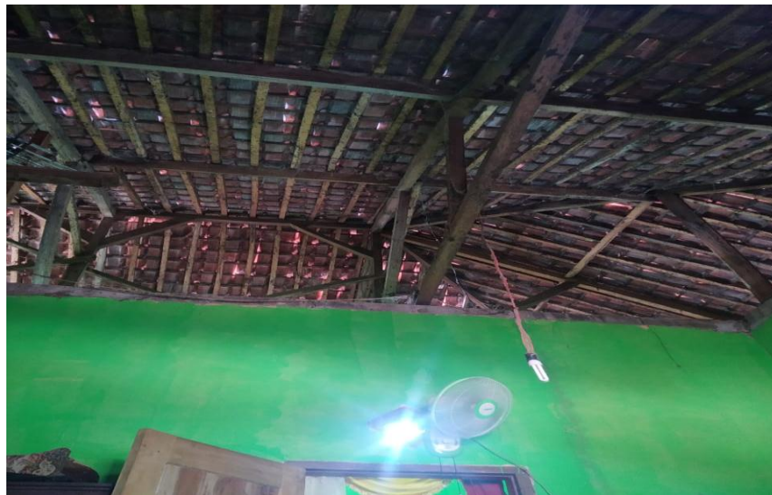
Kondisi Langit-langit Rumah Penderita Tb. Paru Di Wilayah Kerja UPT Puskesmas Rawat Inap Ketapang
