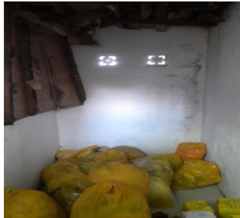
Tumpukan Limbah Medis di TPS Dan kondisi langit – langit TPS yang rusak
