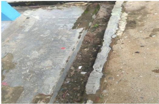
Kondisi Saluran Pembuangan air limbah kondisi TPS yang tidak memenuhi syarat
