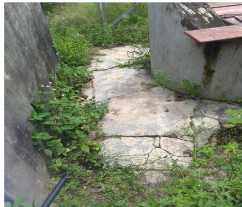
kondisi lantai sumur yang tidak memenuhi syarat
